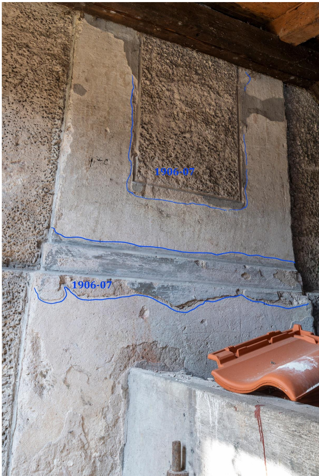
Fot. 36. Fragment ściany wewnątrz kotłowni. Na zagładzonej powierzchni zachowały się fragmenty grubej pobiałej, którą w latach 1906-07 opracowano detal. Pod nią wyprawa z poprzedniej aranżacji elewacji z relikdami jasnougrzewej warstwy malarskiej. Pośrodku lizena fakturalnie opracowana płyцина, wokół której widoczna granica starszego tynku (podkreślona niebieską linią). Tynk z początku XX wieku ma odcień beżowy, ciemniejszy od starszego chronologicznie. Warunki panujące w kotłowni – światło boczne, brak oświetlenia wnętrza oraz drewniany strop utrudniają porównanie wypraw oraz wykonie fotografii bez kolorystycznych zniekształceń.
