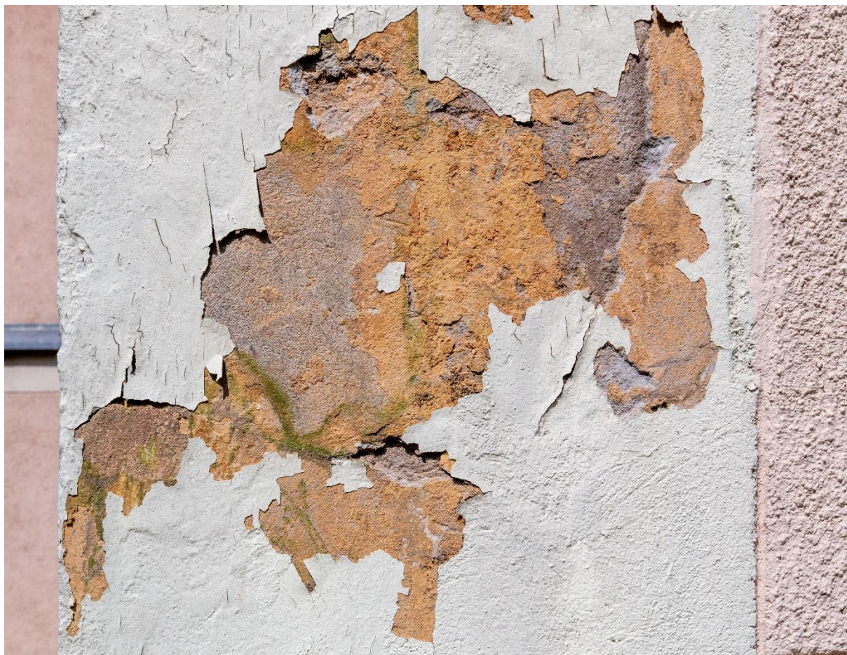
Fot. 31. Zniszczenia na narożniku elewacji południowo-wschodniej. Na wtórnym cementowym tynku warstwa malarska w kolorze pomarańczowym (ciemnożółtym). Podczas ostatniego chronologicznie remontu, który przeprowadzono w latach 2002-05, w tej części korpusu tynk zachowano. W całości wymieniony został fakturalny tynk w tłach.
