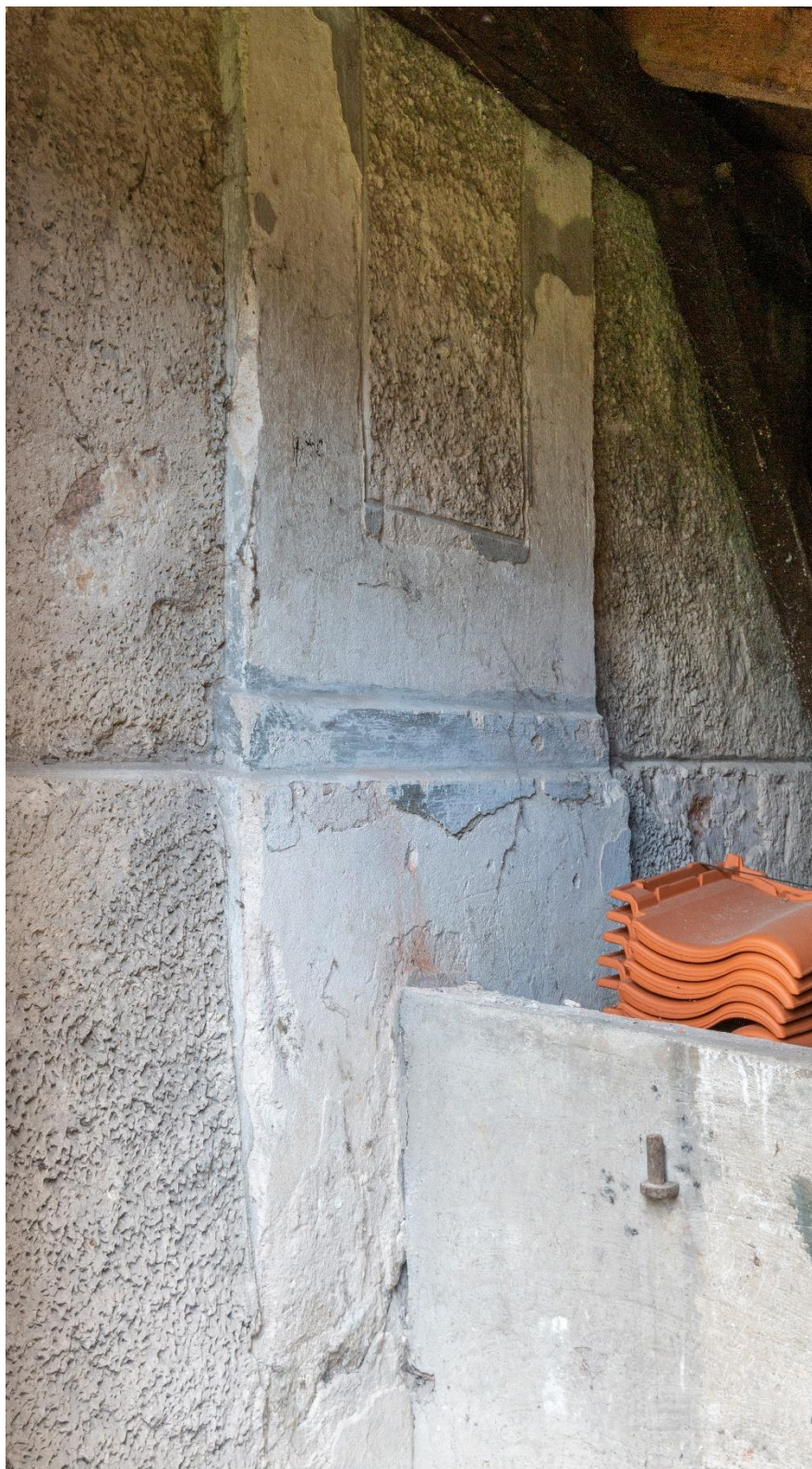
Fot. 33. Fragment południowo-wschodniej ściany kościoła poniżej dachu kotłowni. Fragment lizeny w pobliżu wejścia. Ściany w tłach oraz na płycinach lizen pokryte były fakturalnym, niemalowanym tynkiem. Na detalu tynk opracowano gładko i pokryto grubą warstwą pobiały.
