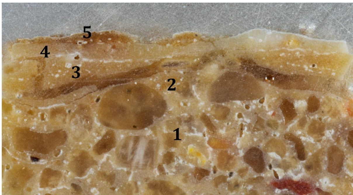
Fot. 38. Fotografia przekroju stratygraficznego próbki pobranej ze starszego chronologicznie opracowania powierzchni lizeny. Zaobserwowano kilka warstw pobiały, najprawdopodobniej wszystkie pochodzą z jednej fazy (może to być ślad poprawek, odnawiania cokołu itp.)
