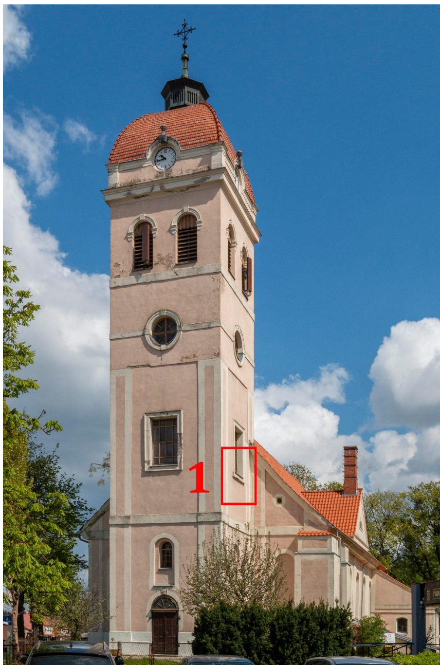
Fot. 27. Wieża oraz południowo-zachodnia elewacja kościoła. Na fotografii zaznaczono lokalizację odkrywkę nr 1 wykonanej na profilowanym obramieniu okna.
