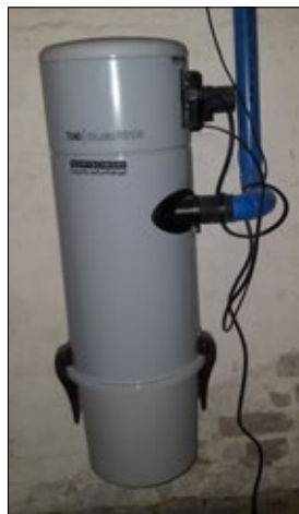
Centralny odkurzacza zamontowany w piwnicy
