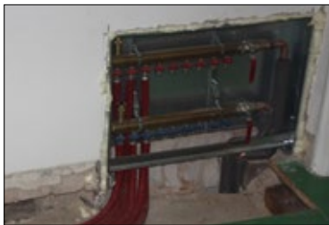
Skrzynka rozdzielcza CO
